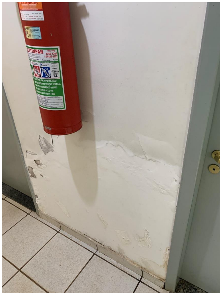
Imagem 11: Parede com infiltração
