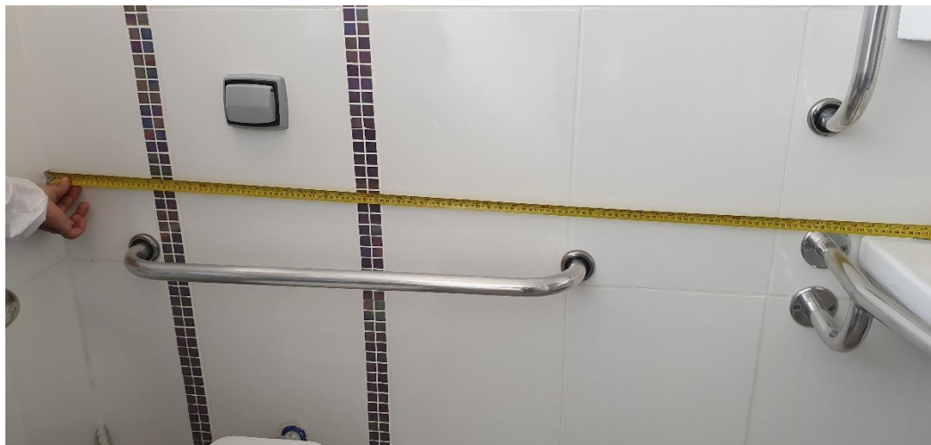
Imagem 6: Irregularidades no banheiro
