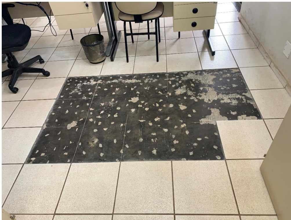
Imagem 3: Piso cerâmico danificado
