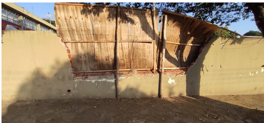
Foto 9: Muro a ser reparado.
