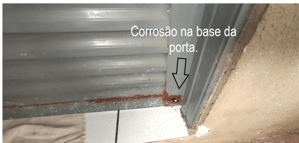
Foto 4: Porta do banheiro da vistoria.
