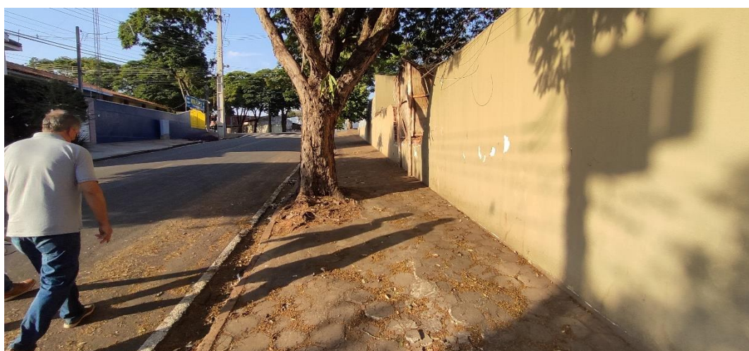
Foto 10: Calçada Externa a ser Substituída.
