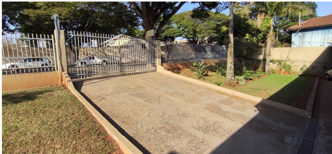
Foto 7: Rampa a ser reconstruída.
