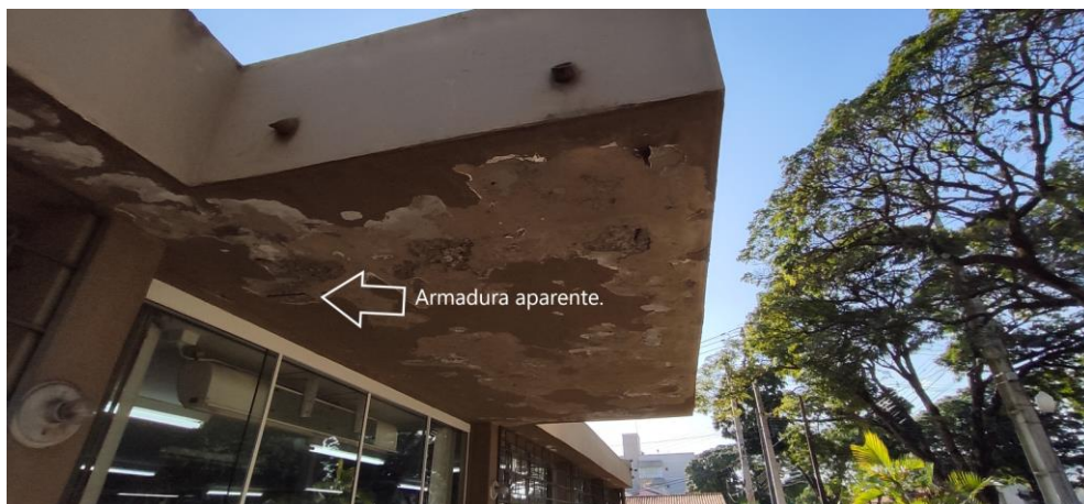
Foto 6: Marquise com armadura aparente.
