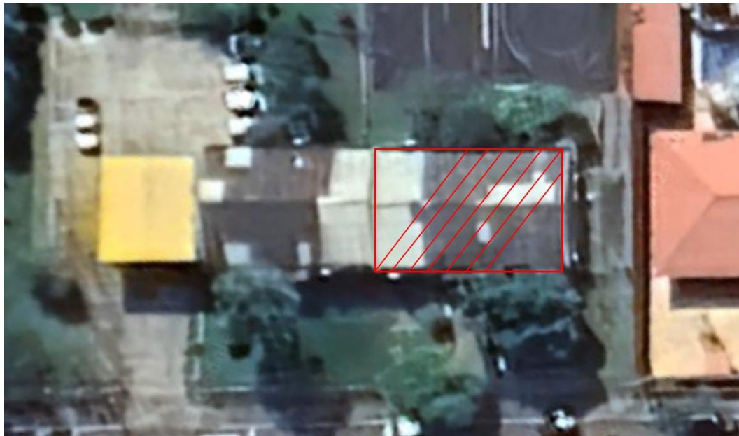
Imagem 12: Área a ser feita substituição total do telhado.
