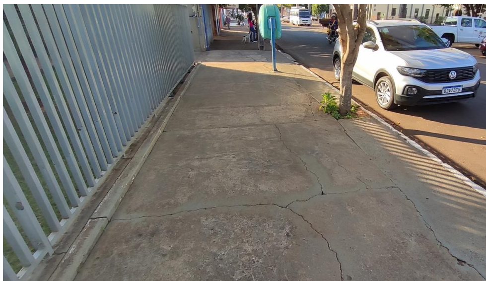
Imagem 7: Calçada a ser reconstruída.
