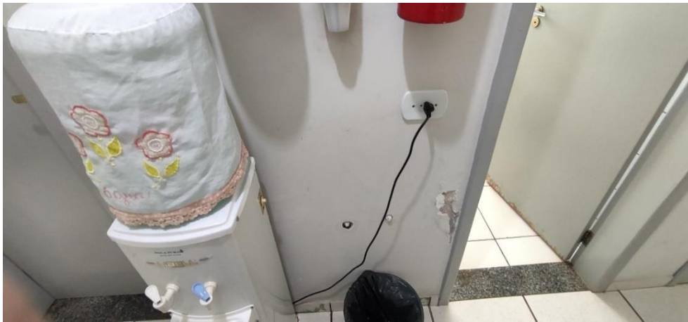
Imagem 8: Parede com infiltração.
