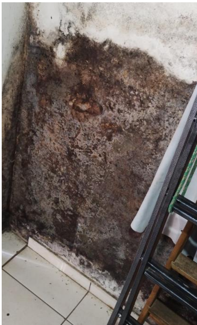
Imagem 2: Infiltração banheiro PCD.
