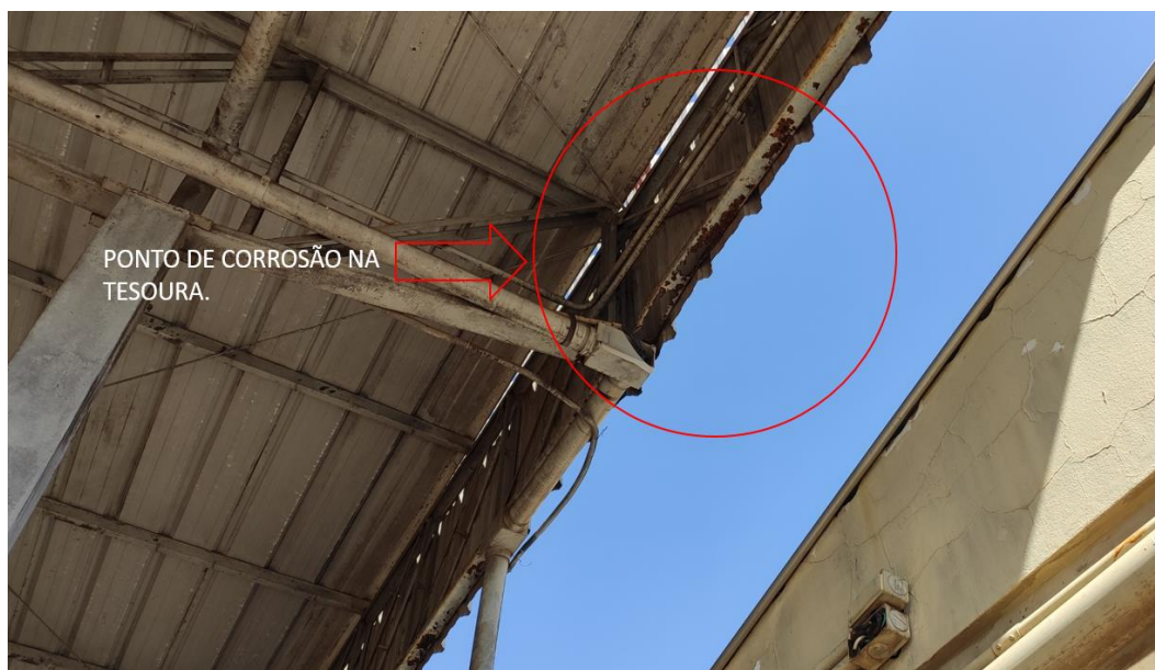
Imagem 1: Patologia na Tesoura Metálica.
