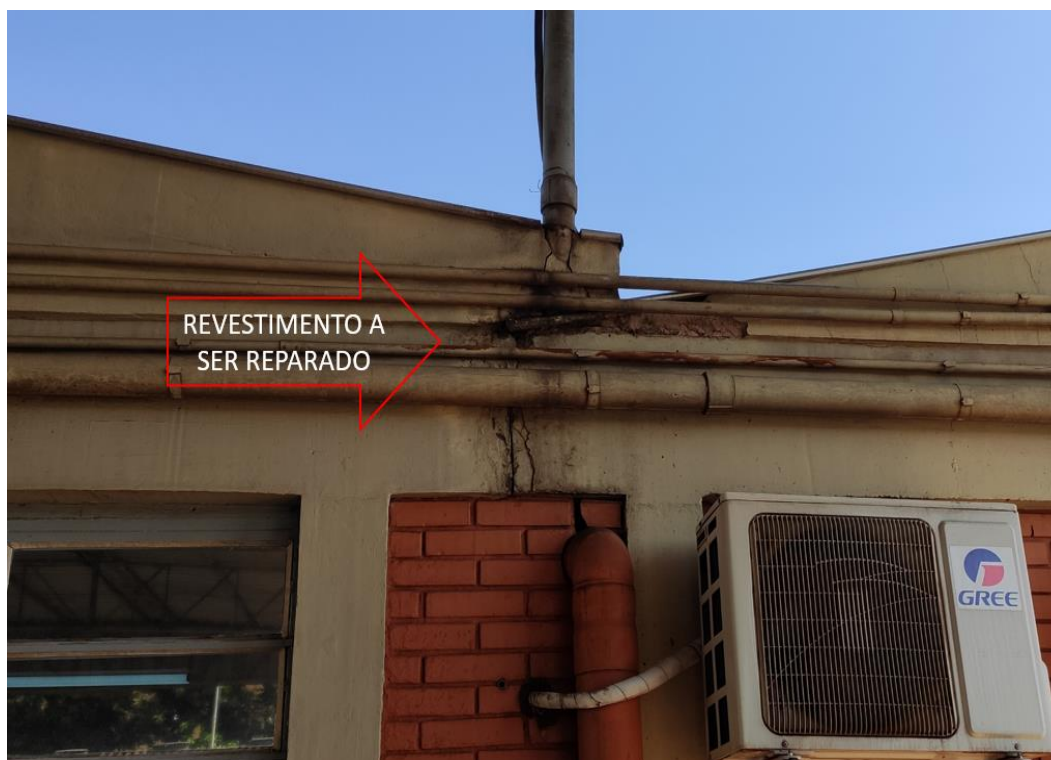
Imagem 10: Patologia na platibanda.
