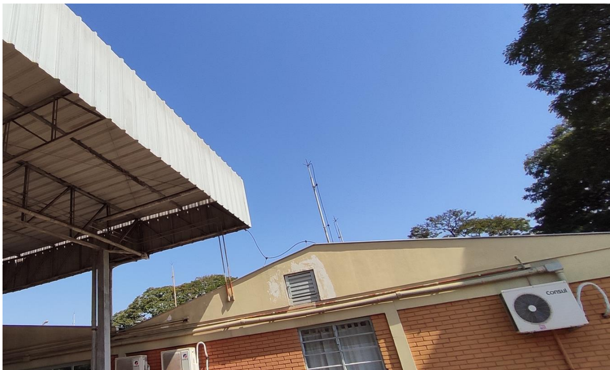
Imagem 13: Eletrodutos de ligação.
