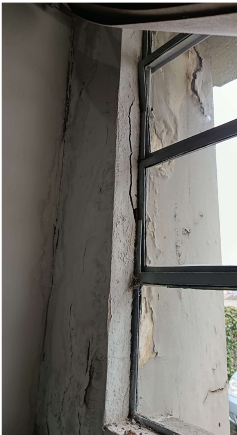
Imagem 10: Ponto a ser executado tratamento.
