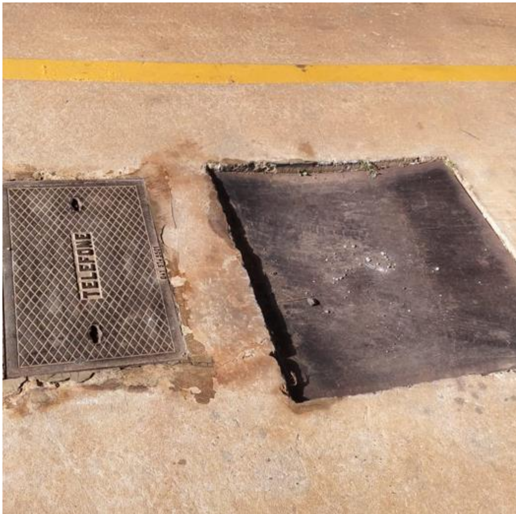
Imagem 6: Caixa de telefonia, substituir por tampa de concreto
