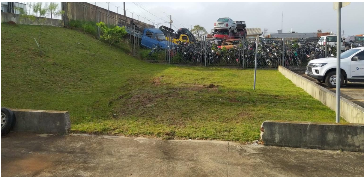
Imagem 4: Mureta a ser corrigida
