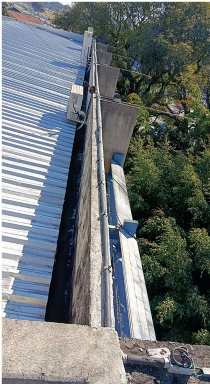
Imagem 14: Componentes elétricos a serem removidos e reinstalados.
