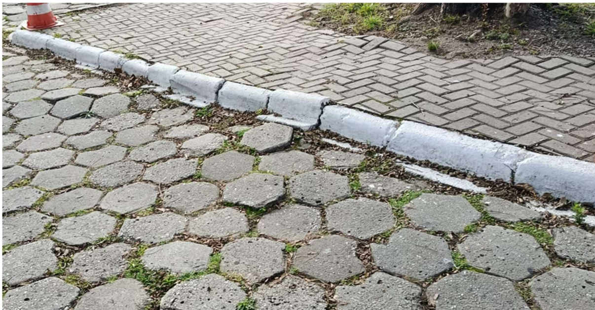
Imagem 8: pontos do meio-fio a serem reassentados e/ou substituídos.
