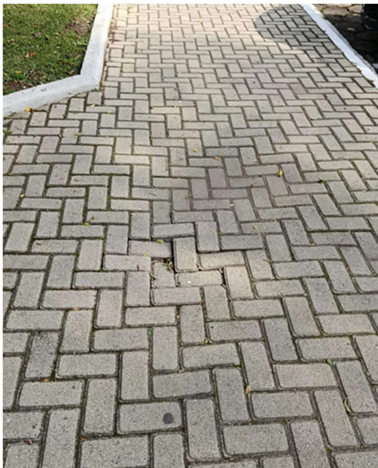
Imagem 6: Pontos de irregularidade na calçada em paver.
