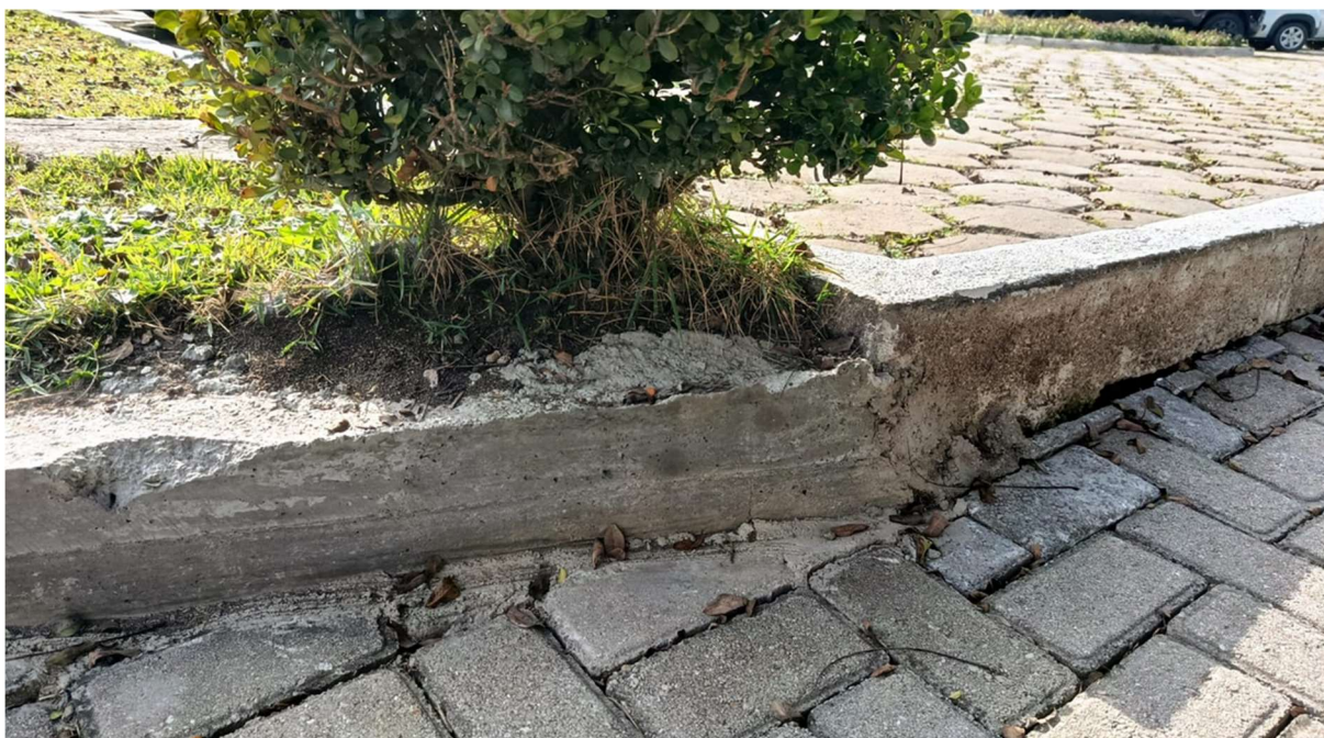
Imagem 10: Mureta a ser executada correção de acabamento e altura.
