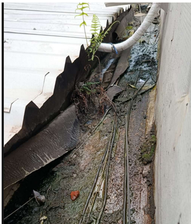
Imagem 2: Mantas soltas com infiltração.
